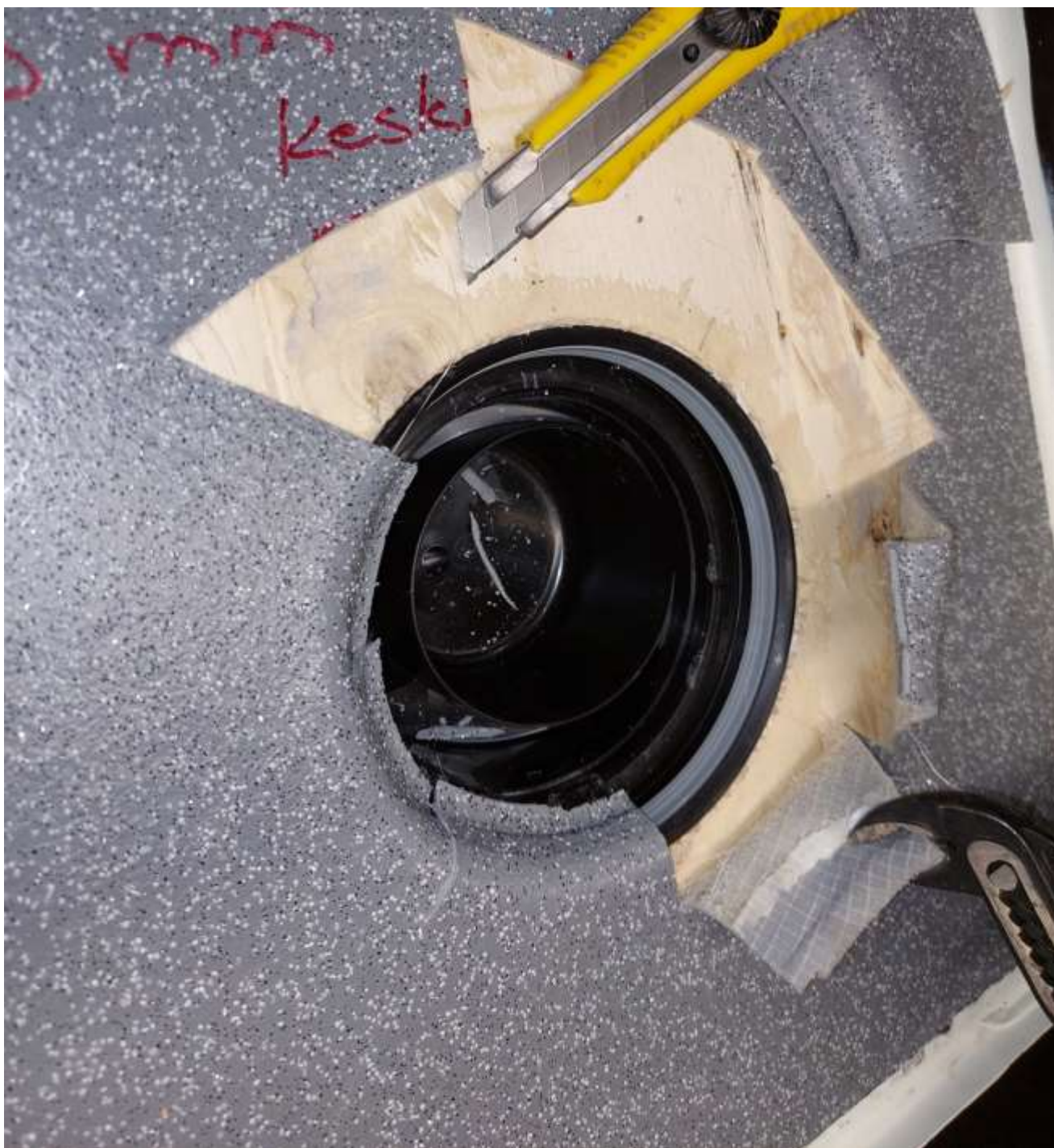
Kuva 2. Maton/lattialaivon vedenpitävyys tarkastettiin lämpötilanvaihtelukokeen jälkeen irrottamalla matto ja tarkastamalla vanerilevyn kuivana pysyminen.
